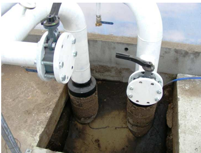
Abb. 7: Einführung der Fernwärmeleitung ins Gewächshaus
