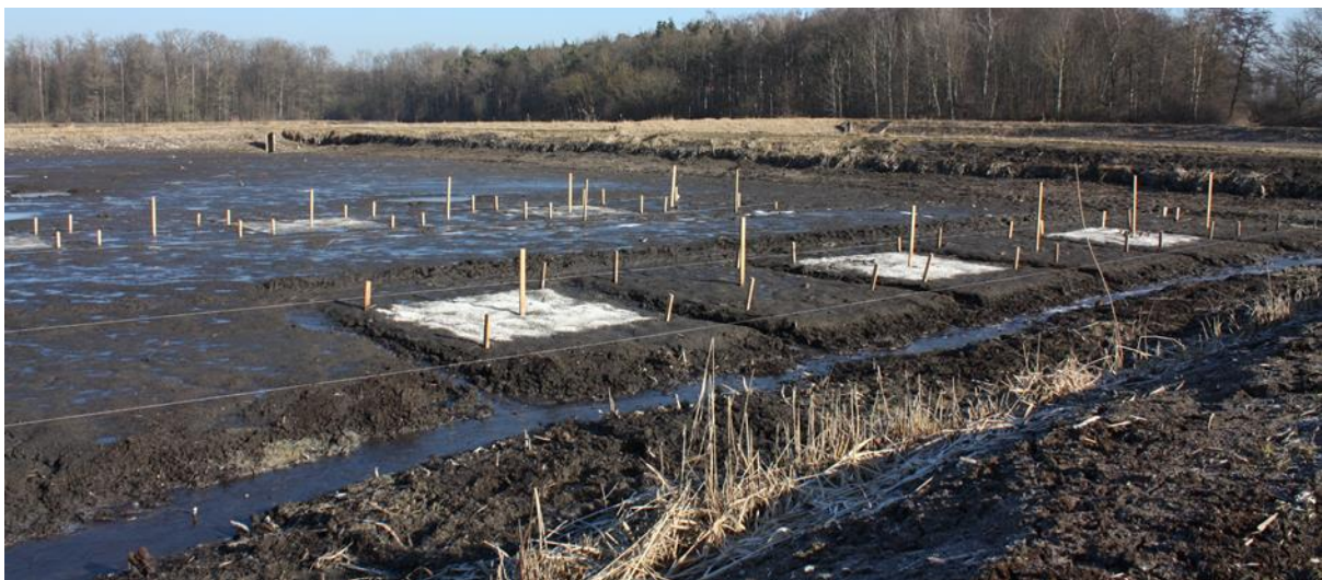
Abb. 17: Anordnung der TPR aus Versuchseinheit III mit 12 Parzellen im leeren Teich. Hierbei wurden Gräben zur Entwässerung bestimmter Parzellen gezogen.
