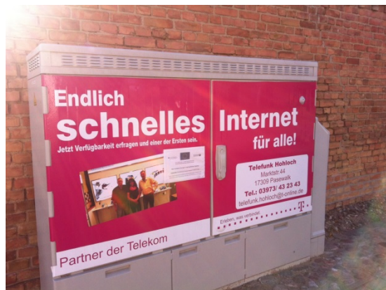
Abbildung 12: Aktiver Kabelverzweiger nach Breitbandausbau in Glasow
