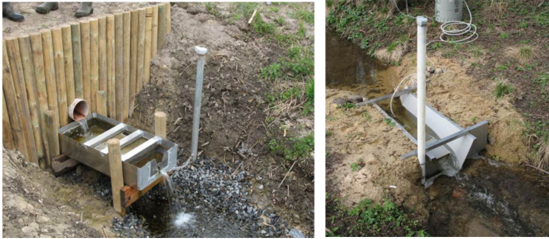
Abbildung 2: Durchflussmeseinrichtungen an den Zuläufen der Retentionsanlagen (links Dreiecksmesswehr, rechts RBC Flume)
