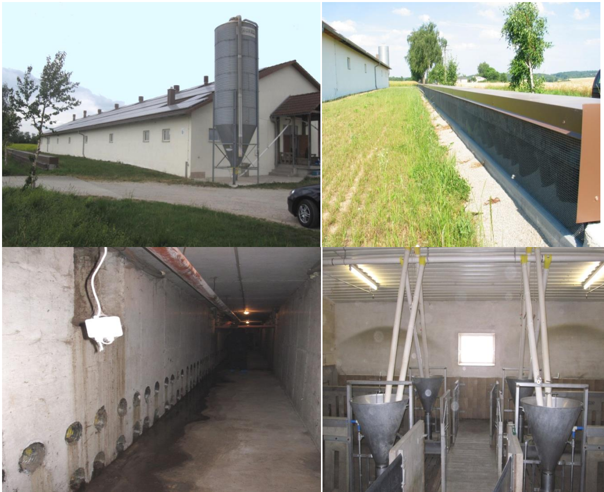
Abb. 19: (oben links) Erdwärmetauscher-Betrieb ( oben rechts) Ansaugseite Rippenrohre (unten links) Eingang der Rippenrohre in den Keller des Stalles (unten rechts) Abteil mit vier Buchten, Zuluft durch Spaltenboden des Zentralganges
