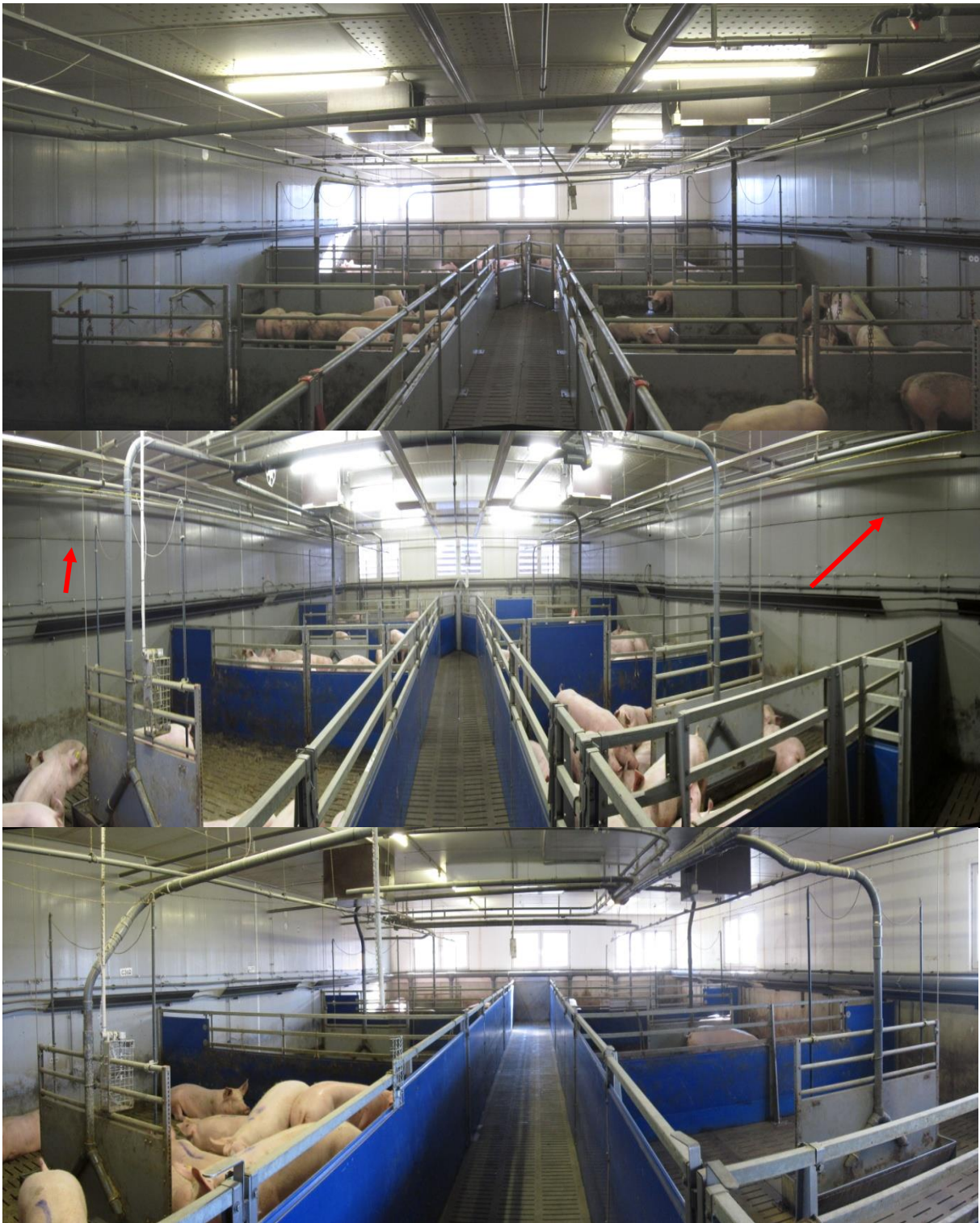
Abb. 13: (oben) Abteil B1 Kühlpad und Abteil C1 Referenz Baugleich Innenausstattung (Mitte) Abteil C2 Hochdruckbefeuchtungsabteil, roter Pfeil zeigt HDB-Leitung (unten) Abteil C3 Unterflurzuluft mit bis zum Ende durchgehendem Versorgungsgang
