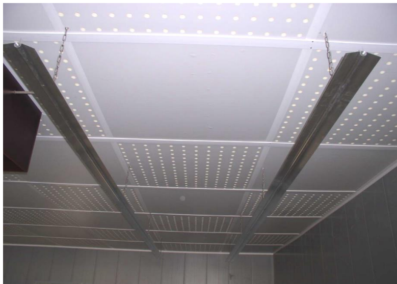
Abb. 16: Porendecke im Schachbrettmuster und Heizungsrohre (Deltarohre) zur Erwärmung der einströmenden Luft. (GEIßLER, 2010)
