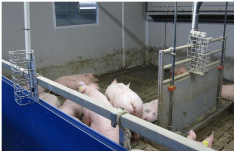
Abb. 56: Beide Temperaturfühler im Abteil der Unterflurlüftung. Der Fühler links im Bild (Punkt (4)) zeichnet die Temperatur der Frischluft auf, wenn sie über die Buchtentrennwand zu den Tieren steigt. Der Fühler am Trog (Punkt (5)) zeichnet die Abteiltemperatur auf.
