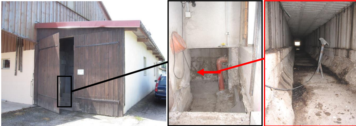
Abb. 22: (rechts) Ansaugen der Frischluft durch das Tor (Mitte) Eingang zum Unterflurkanal (rechts) Unterflurkanal unter Zentralkang mit Temperatur-/ Feuchtefühler. Am Ende des Kanals ist der zweite Lufteinlass zu erkennen.
