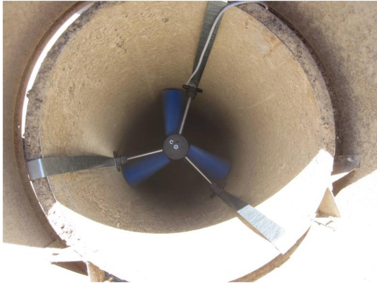
Abb. 31: Von oben eingebauter Messventilator.
