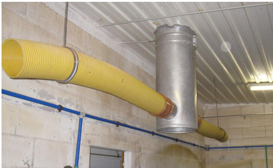
Abb. 20: Dezentraler Abluftschacht mit an der Unterseite befindlicher Schwerkraftklappe am Betrieb A (Erdwärmetauscher).
