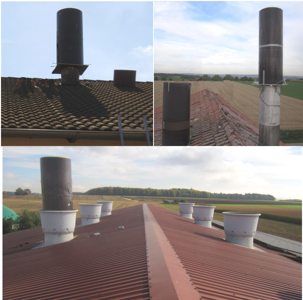
Abb. 32: Kalibration der Messventilatoren auf den Praxisbetrieben. (oben links) Betrieb A Erdwärmetauscher; (oben rechts) Betrieb B Unterflurzuluft; (unten) Betrieb C Hochdruckbefeuchtung
