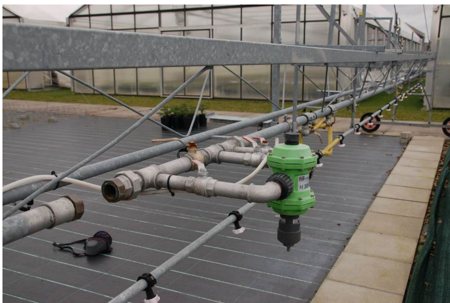
Abbildung 3.20: Proportionaldosiergerät am Gießwagen montiert
