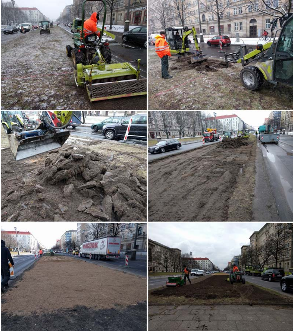
Abb. 3: Anlage der Versuchsfläche auf dem Mittelstreifen der Frankfurter Allee. Die Teilfläche mit Bodenaustausch wurde am 20.3.2018 hergestellt. Aufgrund des Bodenfrostes war das Fräsen auf der zweiten Teilfläche nicht möglich. Die Arbeiten hier erfolgten eine Woche später (Fotos: Blievernicht).
